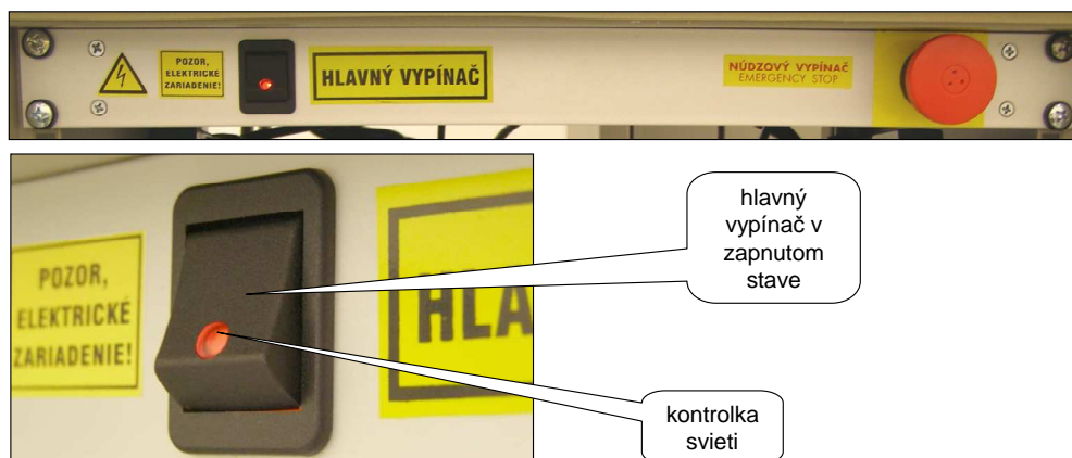
Obr. 4. Pohotovostný stav, hlavný vypínač rozvádzača v zapnutom stave
